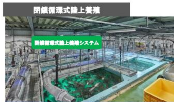
硝化・脱窒槽
